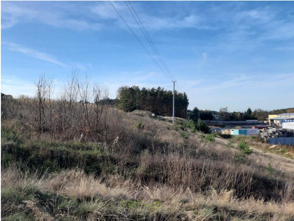
Ryc. 11. Linia elektroenergetyczna w północnej części obszaru opracowania planu
