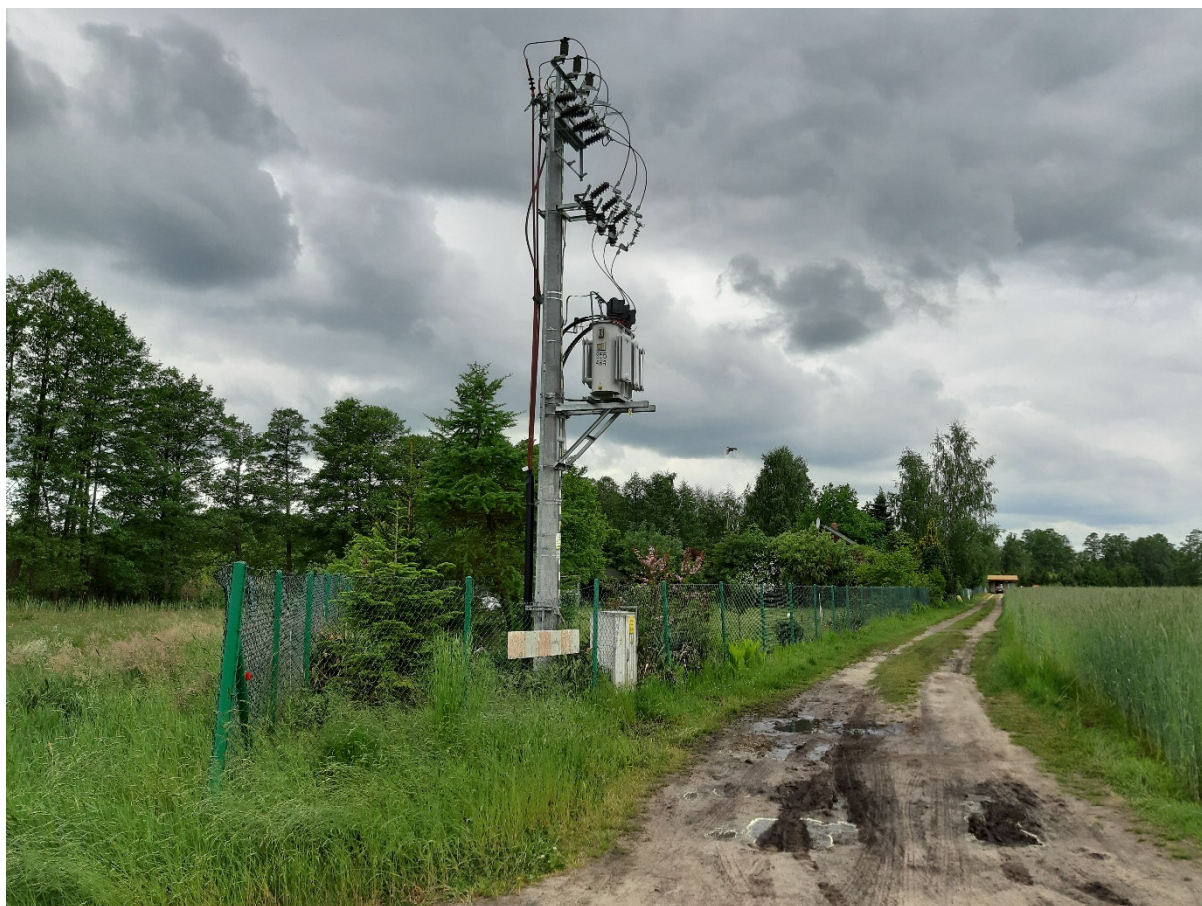
Ryc. 11. Stacja transformatorowa na działce o nr ewid. 138/1
